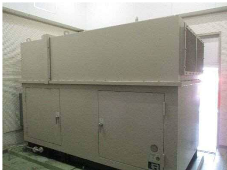
■写真 3-9 自家発電機
