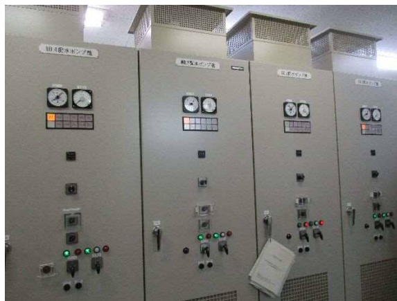
■写真 7-3 配水ポンプ盤 (参考写真)
