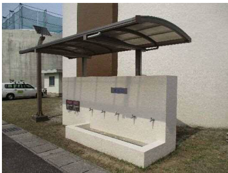
■写真 3-7 水源地内緊急給水設備
