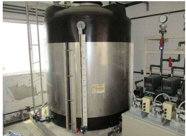
■写真 3-4 塩素タンク
