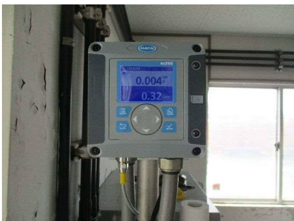
■写真 3-5 原水濁度計
