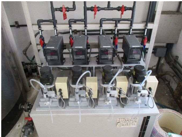
■写真 3-3 塩素注入設備
